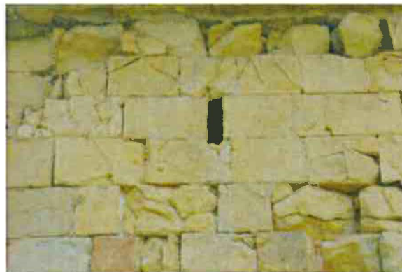
7-Vue de detail: dislocation de la partie haute de la façade. Pierres fissurées ou éclatées.
