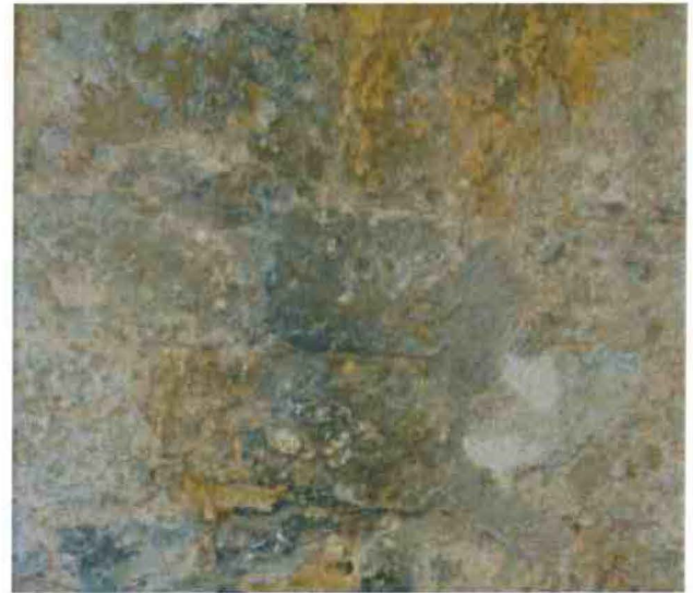
5-Présence d'humidité (tâches noires) remontées capillaires.
