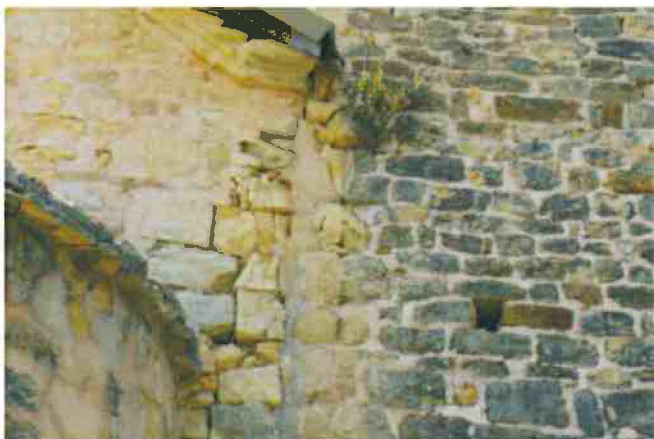
1-Liaisonnement entre le pignon oriental, l'abside et le clocher, présence de végétaux, déchaussement des maçonneries, faible débord des couvertures
