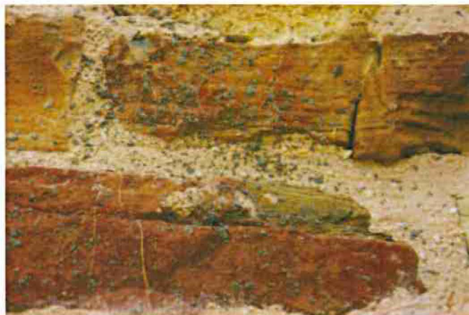
3-Moellons équarris rubéfiés, jointoiement à joint épais, fissuration de la pierre
