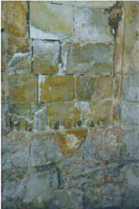
1-Efflorescences salines au niveau de l'ancienne niche.
