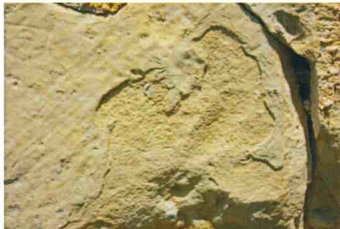
2-Vue de detail: éclatement de la couche superficielle de la pierre de parement (calcin). Rupture du mortier de jointoiment.
