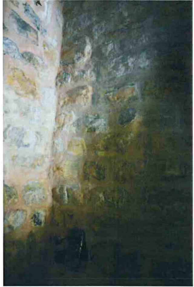
2-Désagrégation de la maçonnerie de l'ébrasement de la baie occidentale de la façade sud.
