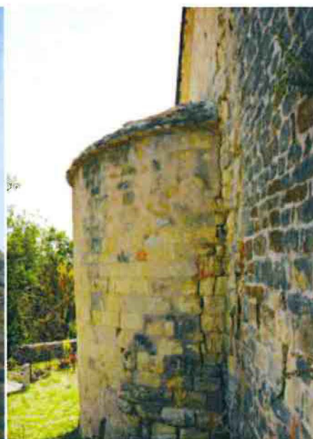
5-Fissuration au départ de l'abside au nord, présence d'algues et de lichens, délitement, éclatement et déchaussement des pierres
