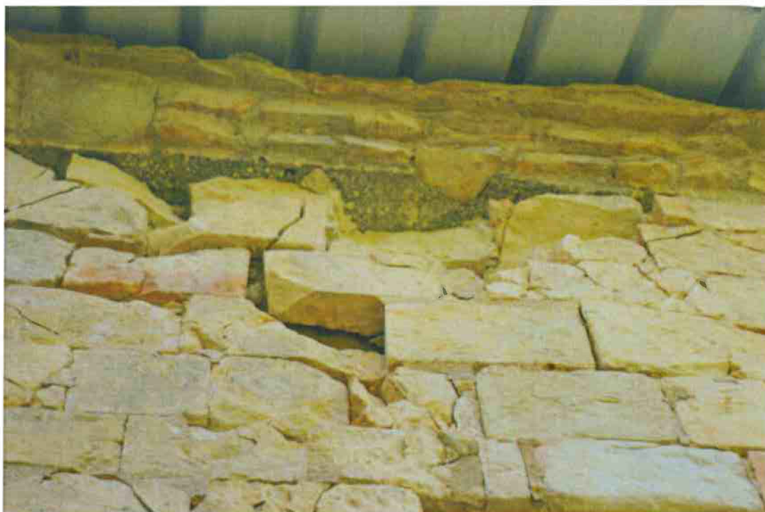
1-Vue de détail: éclatement du bandeau sculpté en tête de mur, éclatement et déchaussement du parement, vue sur le chaînage formant sablière en tête de mur en béton armé, reposant sur le parement et servant de remplissage des maçonneries d'arase.
