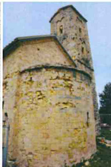
11-Vue sur le chevet: complètement au ciment, enduit à la chaux hydraulique, éclatement des blocs de pierre.
