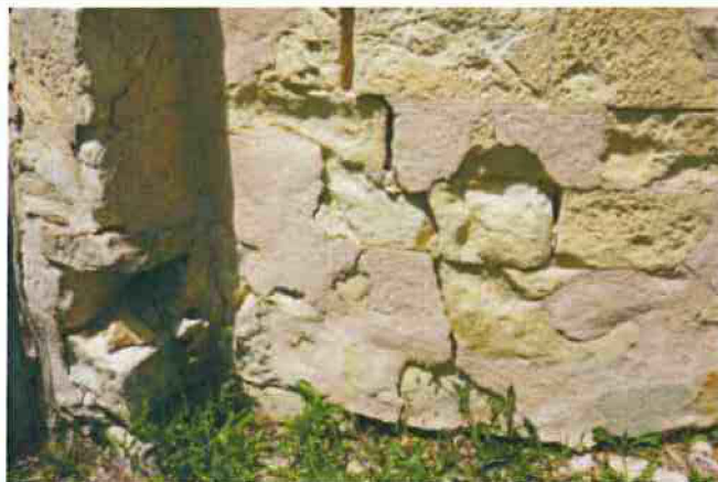
2-base de la façade de l'abside, angle sud-est Mortier de ragréage Fissuration Eclatement et déchaussement des pierres
