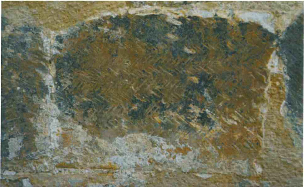
4-Pierre de taille, épiderme taillé en arrêtes de poisson. Mortier en ragréage Présence d'humidité (algues noires) Efflorescences salines (tâches blanches)
