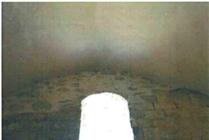
1-Remontage du haut du mur ouest à partir du départ de la baie. Vestige de l'arase ancienne (toiture simple pan).
