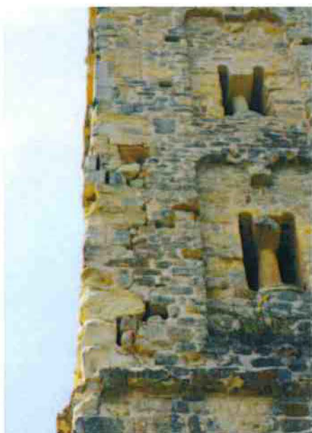
3-Délitement de la chaîne d'angle sud-est du clocher, éclatement et déchaussement des pierres
