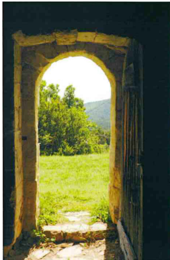
1, 2-Vue sur la baie sud . Linteau intérieur en arc surbaissé avec déchaussement des pierres, linteau extérieur en arc plein cintre. Porte en bois en très mauvais état.
