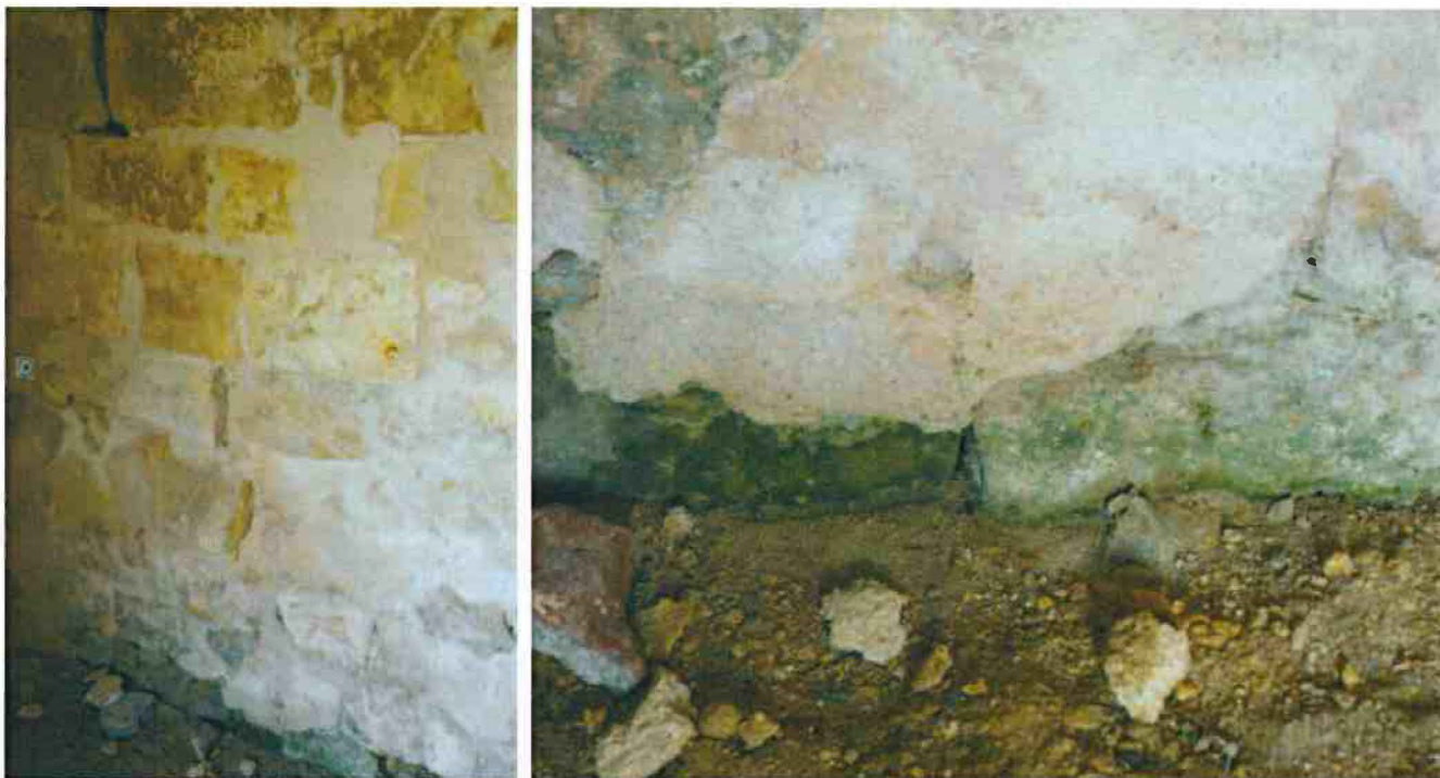
8-Présence d'humidité, algues vertes. Déchaussement de la base du mur. Sape des maçonneries par une humidité surabondante.
