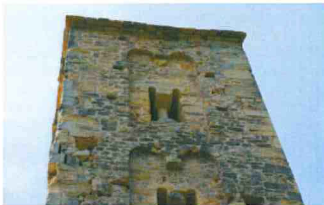
7-Chaîne d'angle nord-est du clocher, éclatement des pierres, présence d'algues et lichens noircissant la pierre
