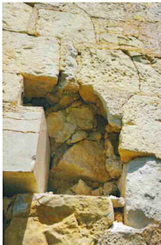
9-Vue de detail: utilisation d'une pierre-dure en appui et linteau de l'une des baies méridionales. Rigidité différentielle à l'origine d'une fissuration et d'un éclatement du parement.
