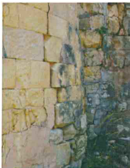
6-Vue de detail:fissuration de la partie nord de la façade de l'abside
