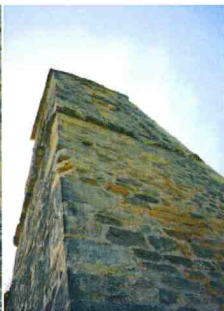
4-Chaîne d'angle nord-est du clocher, éclatement des pierres, présence d'algues et lichens noircissant la pierre
