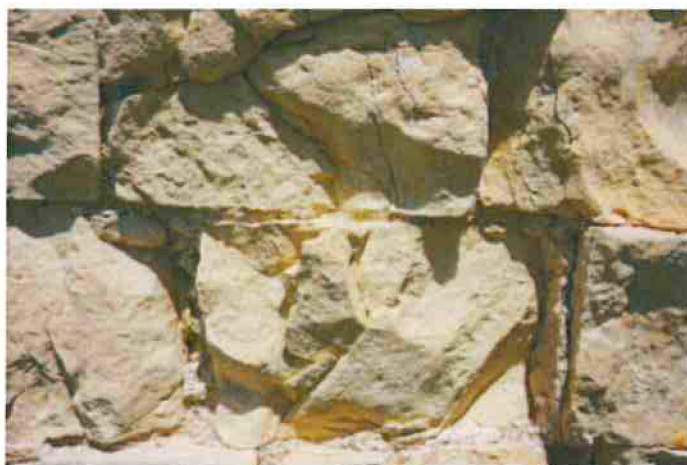
6-Vue de detail: éclatement des parements sur une profondeur supérieure à 4 cm.
