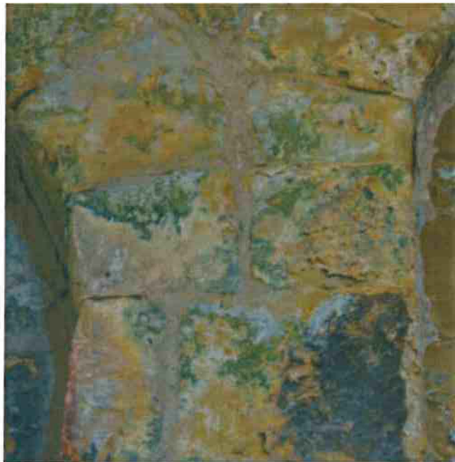
6-Présence d'humidité entraînant une desquamation des surfaces taillées du parement et un décollement des dernières traces de badigeon.
