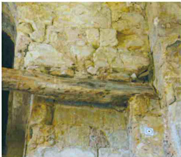
1-Consolidation réalisée dans les années 40, lors de l'ouverture sur la chapelle du clocher. Bois attaqué aux xylophages Vue sur les maçonneries internes en blocage
