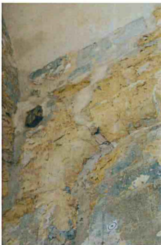
9-Désquamation de l'épiderme des pierres, ragréages et bouchements au mortier. Vestige d'une des poutre encastree de l'ancienne tribune en bois.
