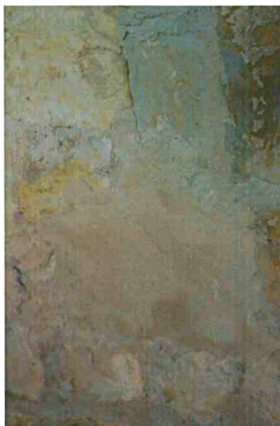
4-Aplat d'enduit, désagrégation de l'épiderme du parement en pierre
