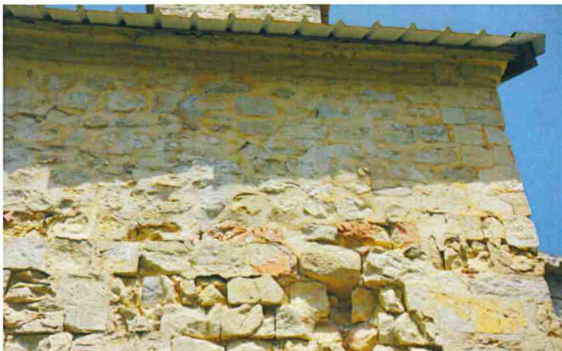
7-Vue de detail: éclatement des joints et des pierres de parements, déchaussement entraînant des chutes de pierres et des vides importants dans les maçonneries.
