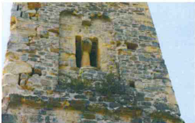
6-Délicatement de la chaîne d'angle sud-est du clocher, éclatement et déchaussement des pierres, végétalisation des parements, éclatement du bandeau
