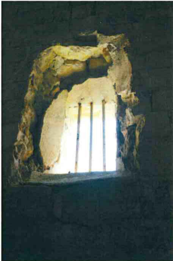
1-Désagrégation de la maçonnerie de l'ébrasement de la baie occidentale de la façade sud. Vue sur les maçonneries internes en blocage
