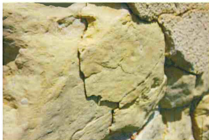
3-Vue de detail: ragréage au mortier de chaux hydraulique, éclatement de la pierre en profondeur.
