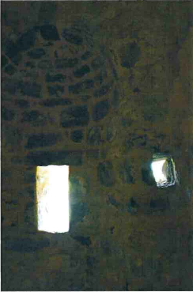
1-Désagrégation de la maçonnerie de l'ébrasement de la baie occidentale de la façade sud.
