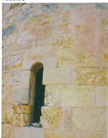
5-Vue de detail: baie de l'abside, éclatement des parties basses de l'encadrement en pierre
