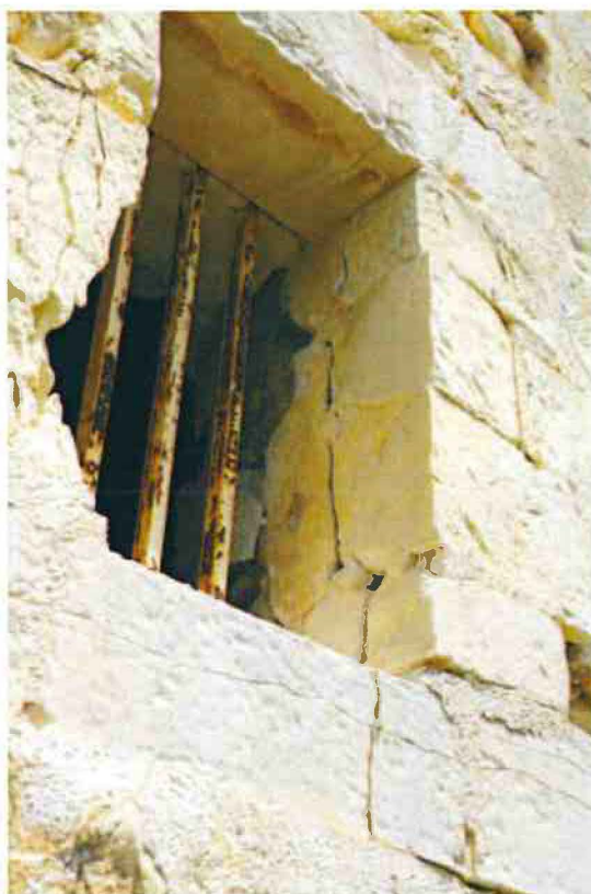
8-Vue de detail: utilisation d'une pierre-dure en appui et linteau de l'une des baies méridionales. Rigidité différentielle à l'origine d'une fissuration des parements.
