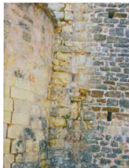
7-Jonction entre l'abside, le pignon et le clocher côté nord, désagrégation des maçonneries, déchaussement et éclatement des pierres
