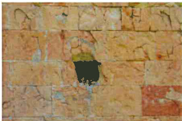
6-Vue de detail: morceau de pierre manquant, tomber sous l'effet de la pression due au gonflement de la pierre gorgée d'eau. Pierres rubéfiées
