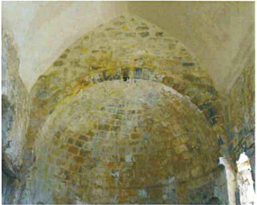
2-Vue sur la voûte en cul de four (tâches blondes, efflorescences salines, tâches noires présence d'algues témoins d'humidité )
