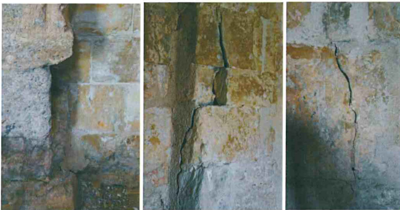
7-Fissuration des pilastres des bandes lombardes
