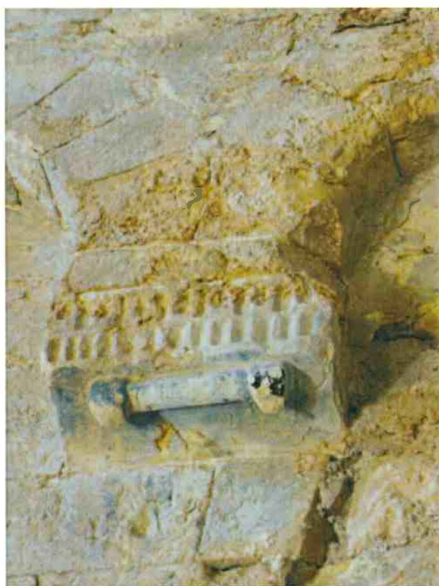
3-Console sculpté reliant les deux arcatures plein cintre de l'une des bandes lombardes. Desquamation des pierres au niveau des arcatures.
