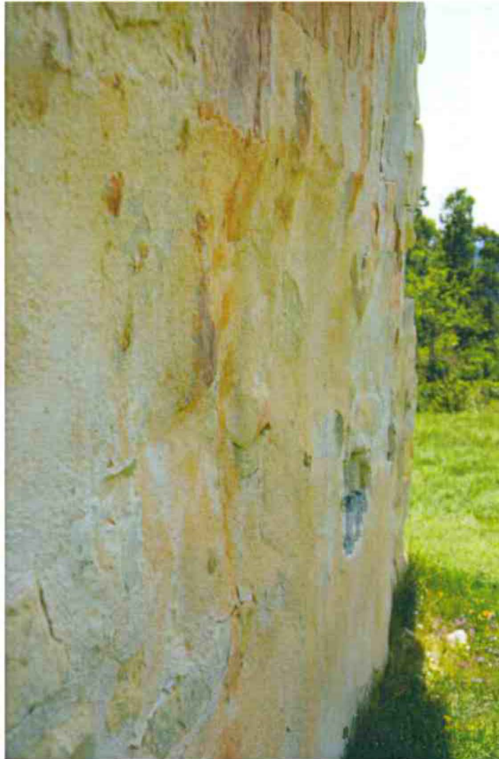
7-Surface de parement absente, comblement au ciment, enduit à la chaux hydraulique.
