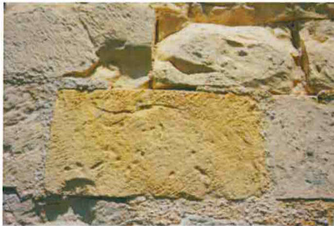
5-Vue de detail: comblement au mortier de chaux hydraulique. Disparition progressive des mortiers de ragréage.
