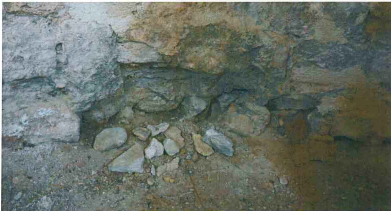
5-Désagrégation de la maçonnerie en pied de mur de l'abside, présence d'humidité.
