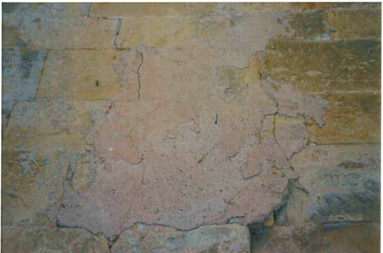
6-Aplat d'enduit en ragréage, déliaisonnement des maçonneries.
