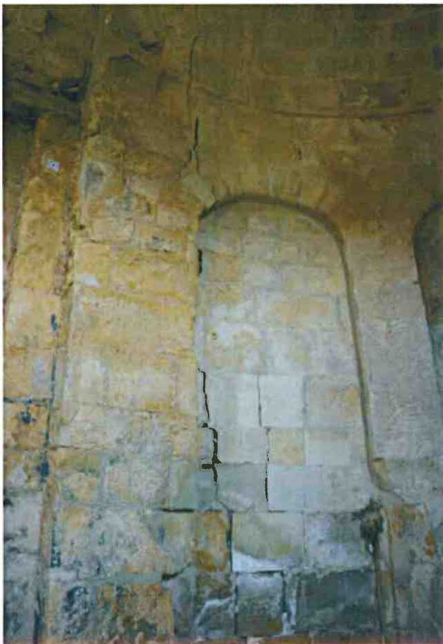
3-Fissuration intérieure à la liaison entre l'abside et la nef.
