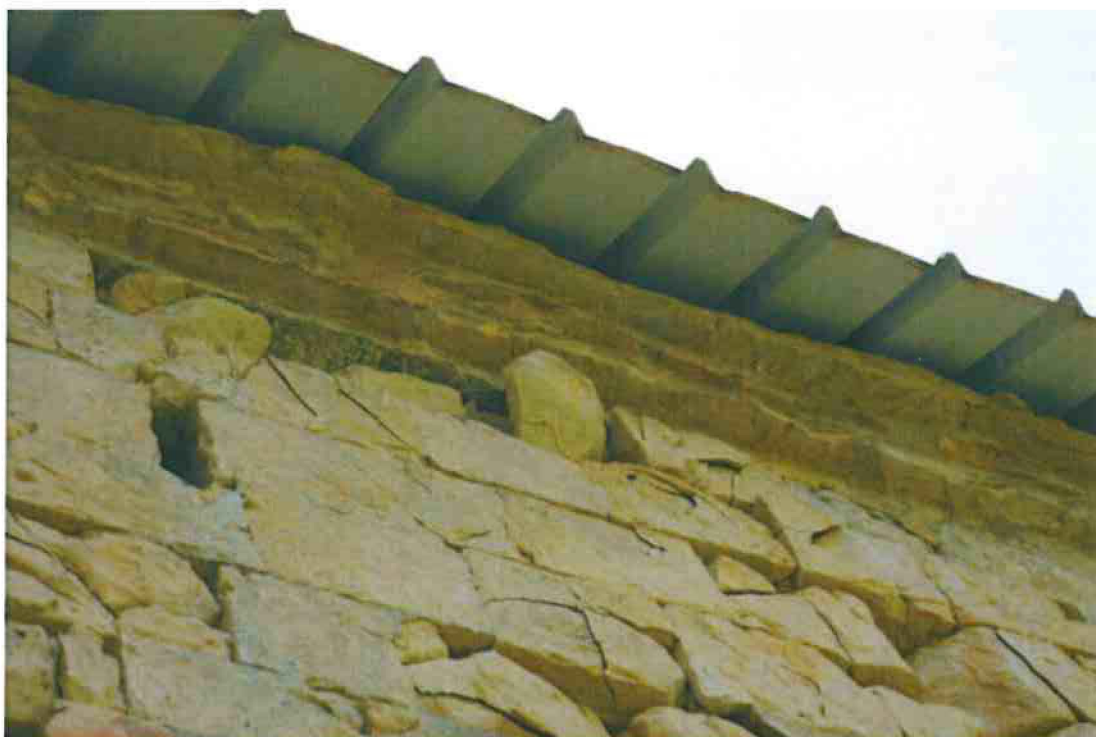
2-Faible débord de la toiture en lauze et débord insuffisant de la sur-toiture en bac acier. Parement éclaté, fissuré, manques importants, pathologie en cours, chutes de pierres Déjointoiement complet du parement
