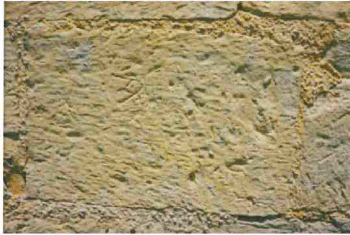
4-Vue de detail: joints repris, plus épais, en ragréage des morceaux de pierres manquants. Décollement des joints.
