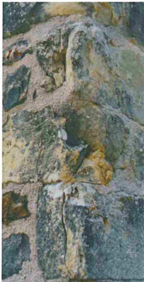
9-Vue de détail: joints épais, fractionnement et fissuration des pierres aux angles
